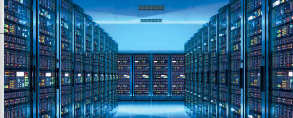
Inneres eines Serverraumes in einem Rechenzentrum. © depositphotos.com
